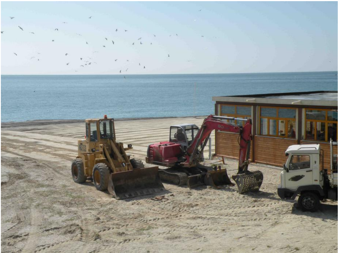
Fig. 19. 23 aprile 2013: lavori in corso sulle spiagge del Comune di Bergeggi per la preparazione della stagione balneare.
